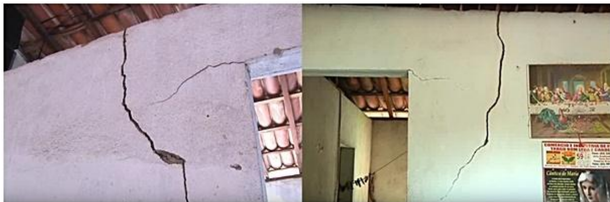
FIGURA 23: Rachaduras em casa “condenada” pela Defesa Civil
