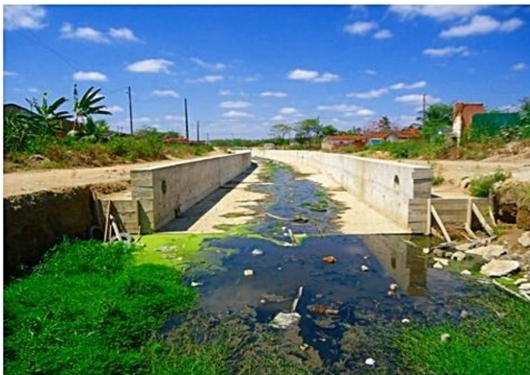
FIGURA 33: Esgoto a céu aberto e interrupção de construção de canal.
