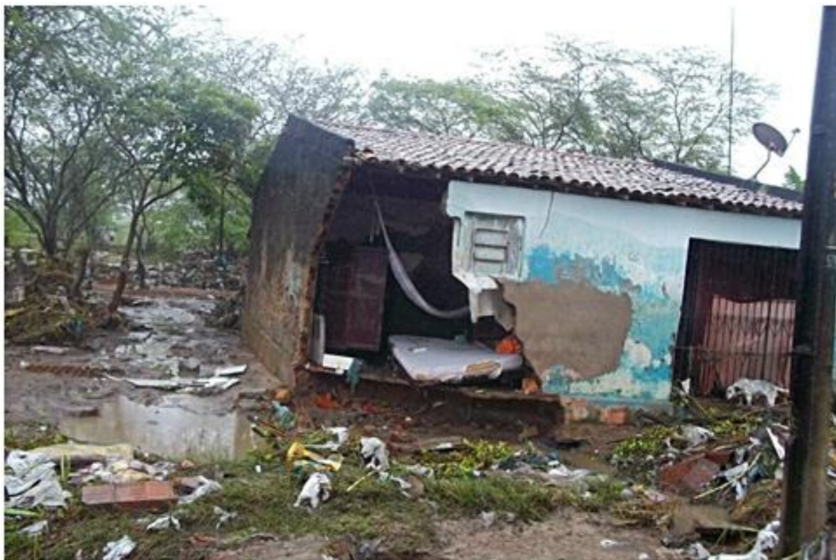
FIGURA 19: Casa destruída após enchente/inundação perda total da casa.
