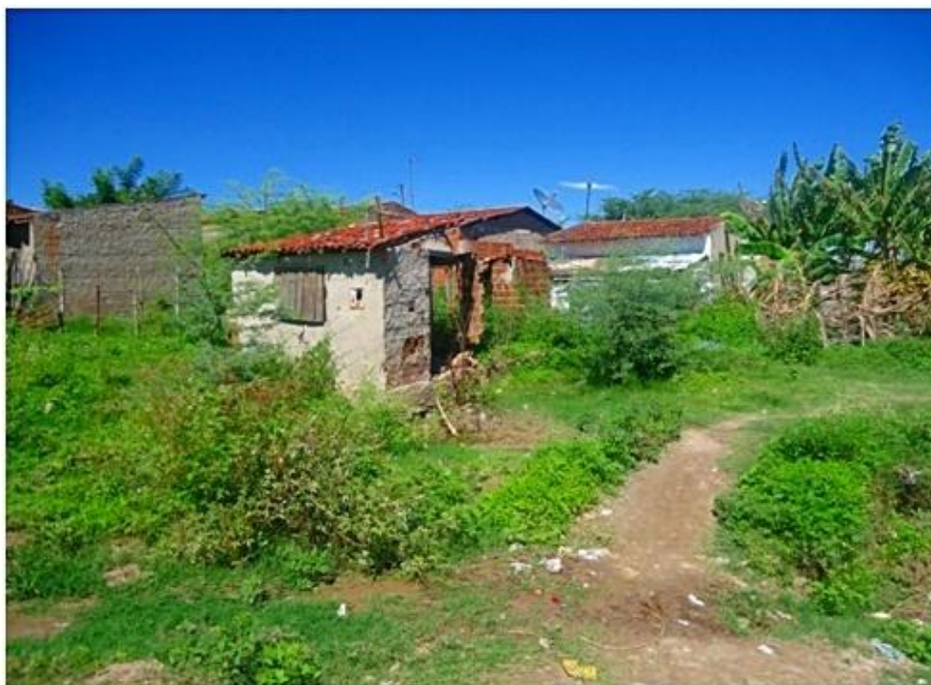
FIGURA 30: Casa destruída em pela enchente/inundação de 2011.
