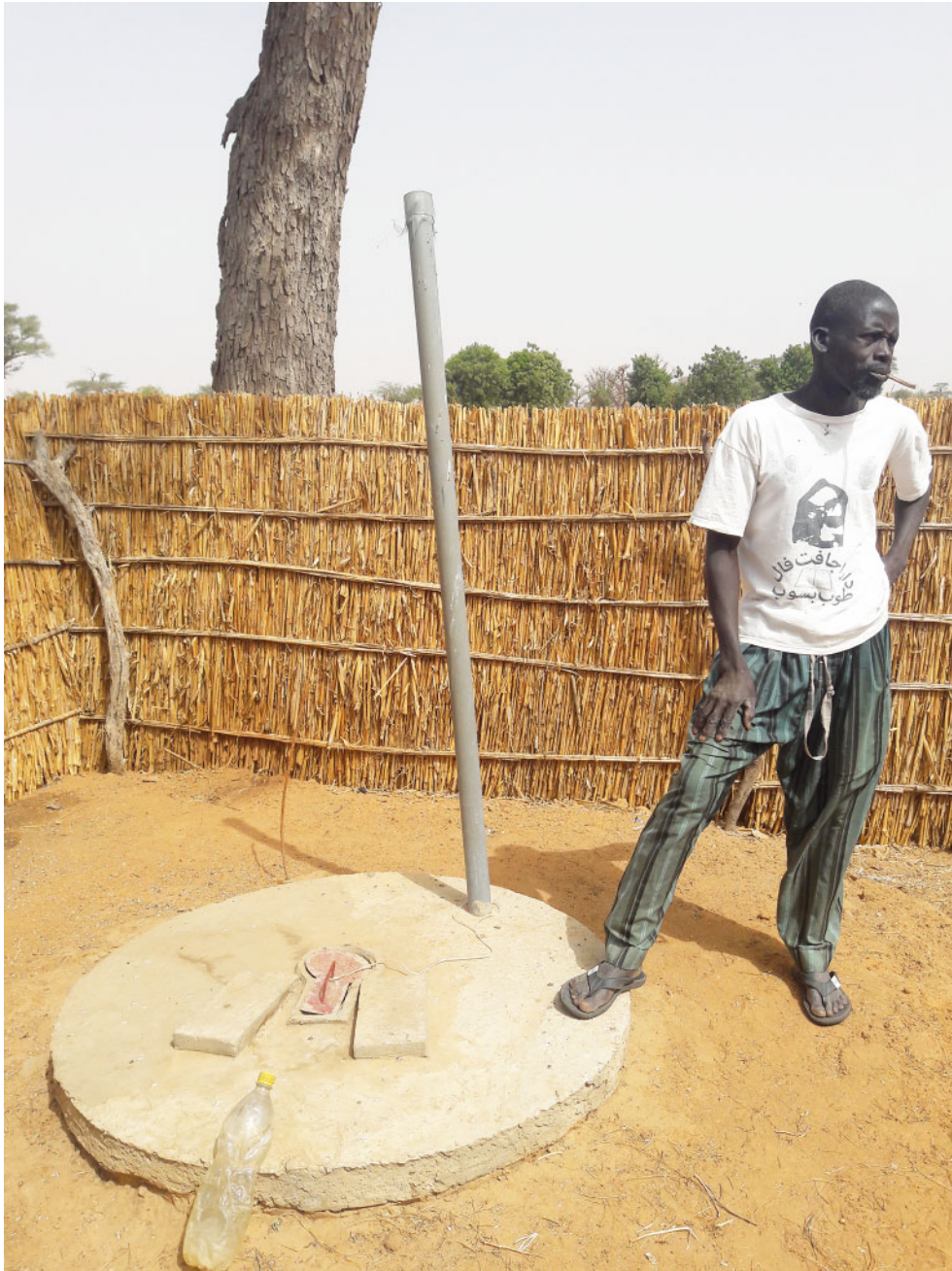
Chef de ménage bénéficiaire posant devant sa latrine Sanplat dans la commune de Missirah
